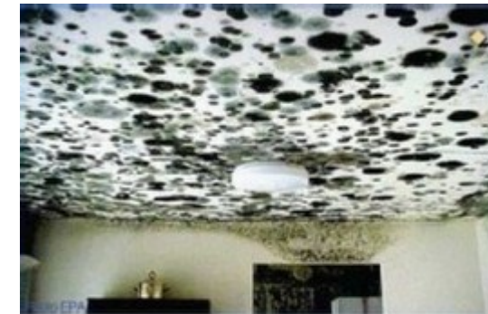
Dégâts sur le bâti
